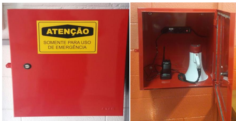
Figura 4 – Caixa de Emergência.
